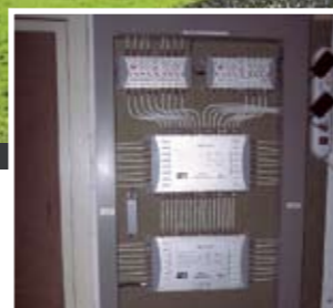
In de machinekamer van de flats installeerde Van Meurs een verdeelkast voor de satellietsignalen
